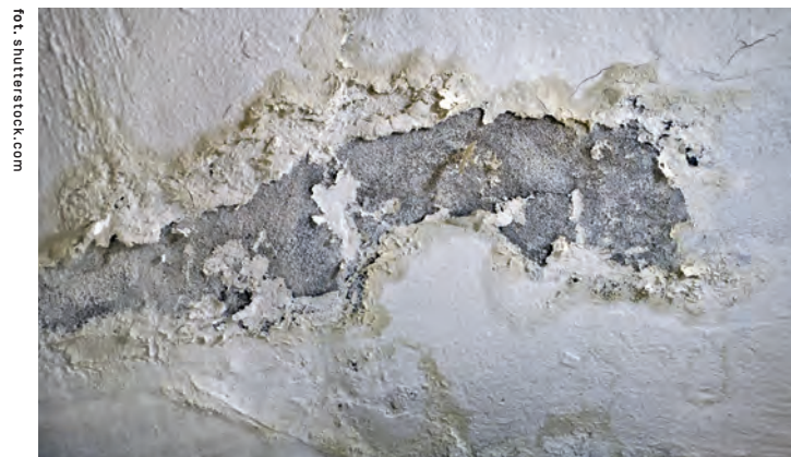
Przykład skutków zaprojektowania ściany z balkonem w oparciu o uproszczoną metodę obliczania mostka cieplnego.
