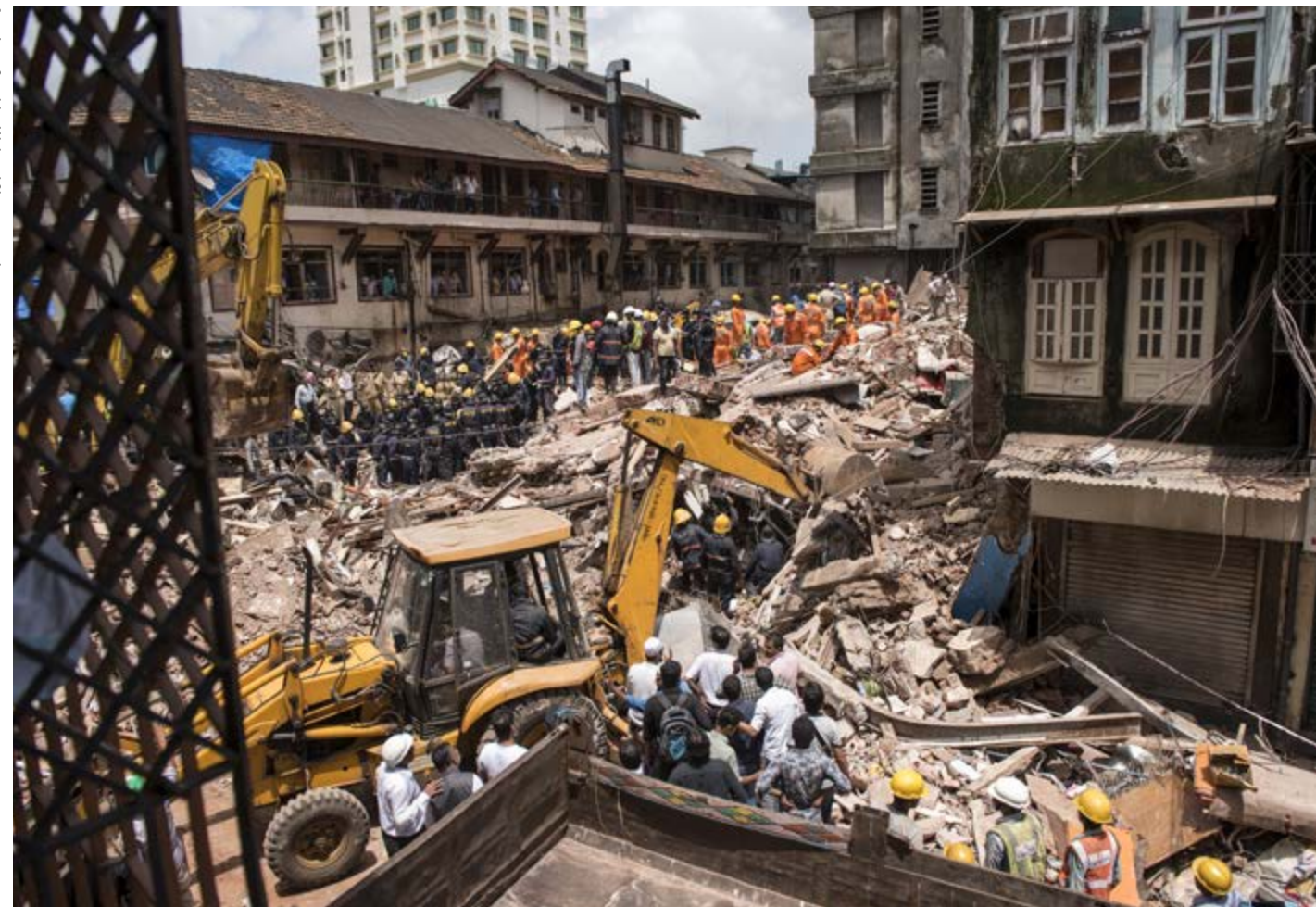
Jedna z często zdarzających się w Mumbaju katastrof budowlanych, Bhandi Bazaar.
