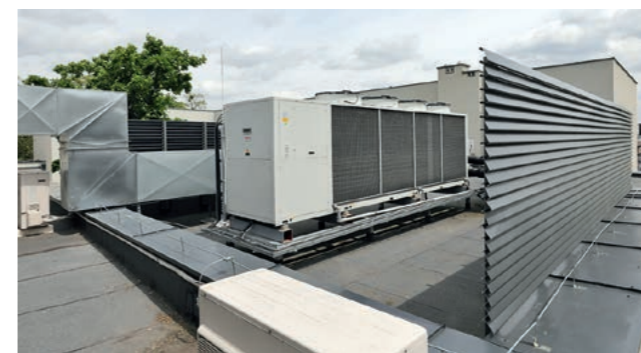
Powietrzna pompa ciepła na dachu płaskim budynku wielorodzinnego.
