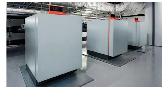
Maszynownia z gruntowymi pompami ciepła.
